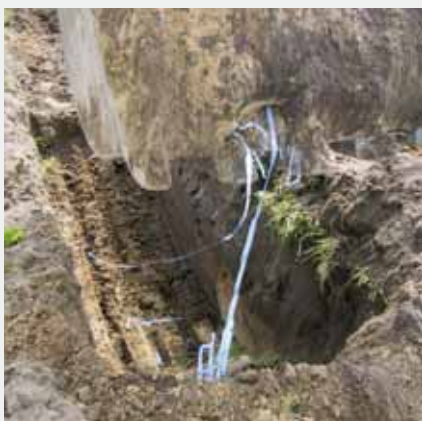
Synlige nettråde ved opgravning
